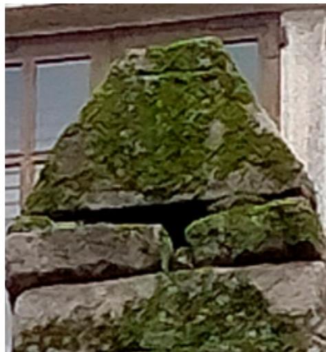
Escudo en mal estado de conservación y sin la parte superior.
